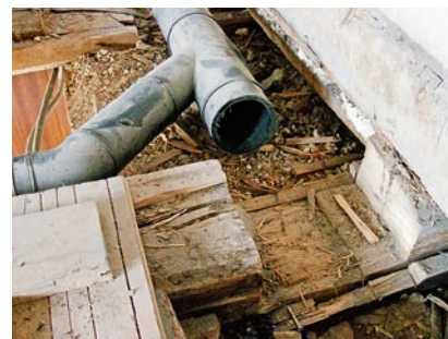
Structure porteuse affaiblie par la suppression de poutres.
