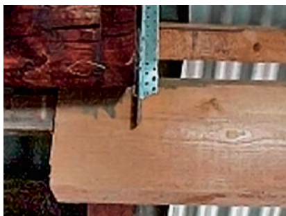
Transformation avec des liaisons sous-dimensionnées.
