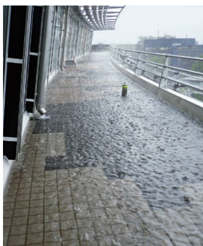
L'eau peut pénétrer dans les pièces lorsqu'elle s'accumule, même brièvement, sur des toits plats ou
