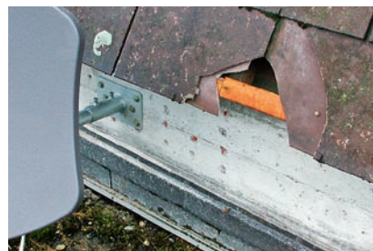
Éclatement de plaques en fibres-ciment.
