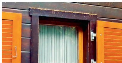
Dommages structurels par arrachement d'angles exposés
