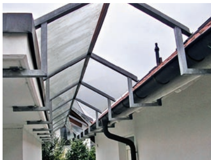
Exemple de toit intermédiaire endommagé par de la neige ayant glissé du toit principal.
