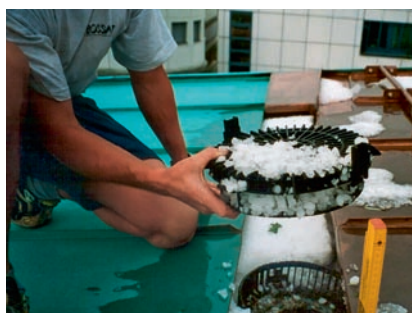
Exemple de dispositif d'évacuation des eaux de toiture engorgé par une importante accumulation de grêlons.
