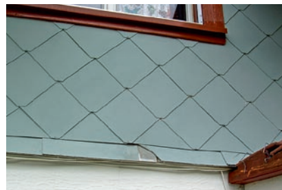
Éclatement de plaques en fibres-ciment.
