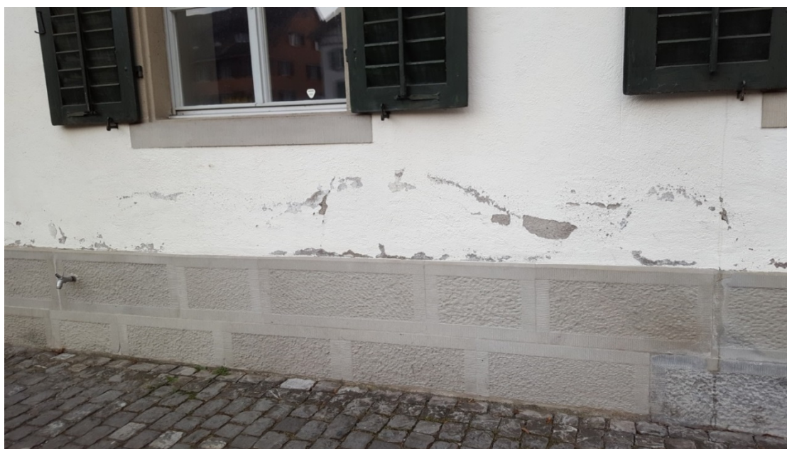
Figure 27 : Fissures et éclatements dans la couche de finition d'un mur en pierre crépi à cause de l'humidité excessive et des cycles de gel/dégel, exemple d'un bâtiment à Küsnacht.
