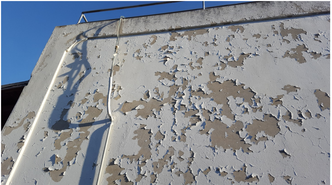
Figure 33 : Éclatement massif dans la couche de finition sur crépi ; probablement dû à une mauvaise combinaison de matériaux (peinture acrylique sur enduit organique?) dans un climat méditerranéen agressif (eau salée et vent), exemple d'un bâtiment à Stromboli (île dans le sud de l'Italie).
