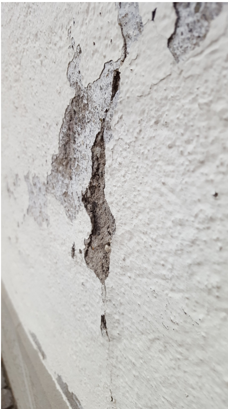
Figure 28 : Détails de la figure 29 : écaillage de la couche de peinture et éclatements dans la couche de finition dans la zone d'une fissure étendue.
