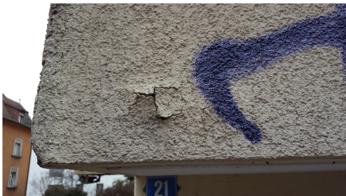
Figure 26 : Formation de cloques et de fissures, exemple d'un bâtiment à Zurich
