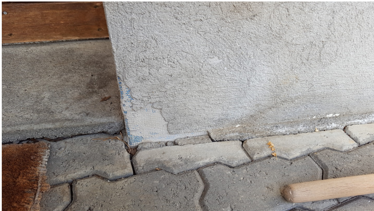
Figure 31 : Éclatement dans la couche de finition dû à des dommages mécaniques (probablement causés par l'impact de raquettes ou d'une pelle à neige) combinés à des cycles de gel/dégel, exemple d'un bâtiment à Grindelwald.
