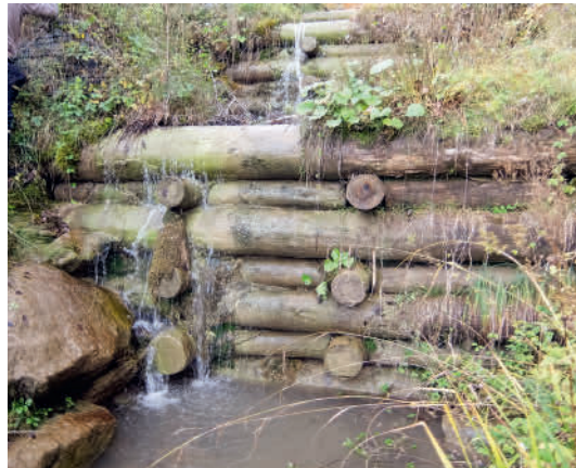
Figur 7 24 Jahre alte Wildbachsperre aus Holz (Hergiswil NW) mit beginnender Holzzersetzung im wechselfeuchten Bereich rechts unter der Verlandung und dem Sperrenflügel.
