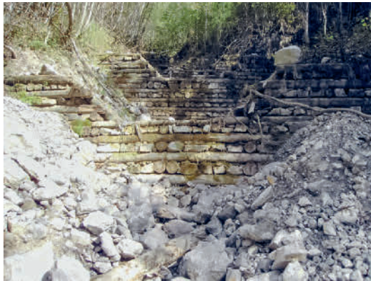
Figur 40 Ausfächung mittels Steinen: Holzsperrre nach Beanspruchung durch Murgang.
