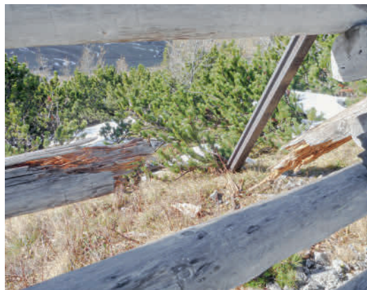
Figur 60 Gebrochener morscher Rostbalken einer kombinierten Holz-Stahl-Schneebrücke.
