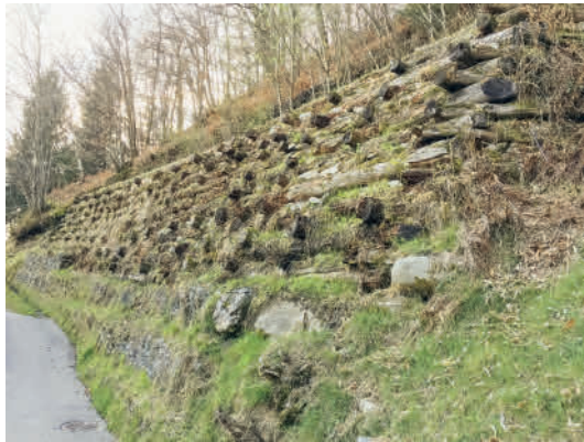
Figur 29 (links) Doppelwandige Holzkästen mit Anzeichen von Mängeln bezüglich Tragsicherheit nach ca. 30 Jahren. Vermutlich wären eine flachere Ausbildung und Bepflanzung erfolgreicher.
