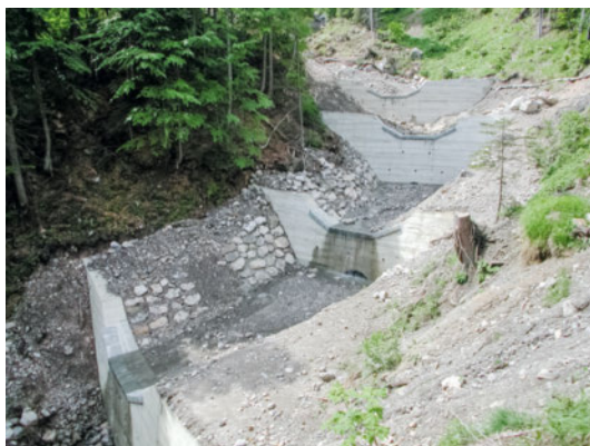
Immagine 61 (a sinistra) Opere trasversali (briglie) in calcestruzzo nel Mauer- bodenbach risalenti al 2006/2007 [65].
