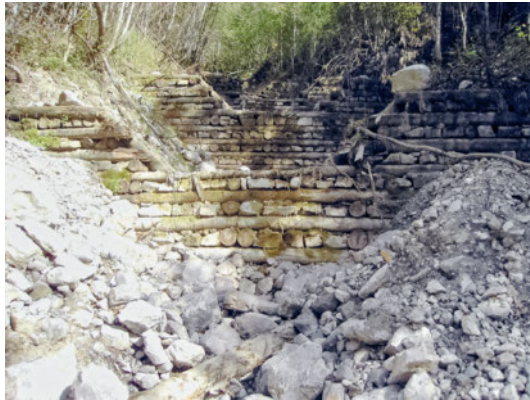
Immagine 40 Tamponamento mediante blocchi di pietra: briglie dopo un flusso detritico.
