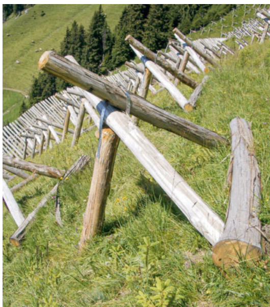
Immagine 55 Treppiedi con soglia a monte a protezione delle piante giovani contro slittamento e reptazione della neve
