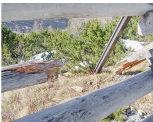
Immagine 60 Rottura di una traversa marcia della griglia di una struttura combinata legno-acciaio.
