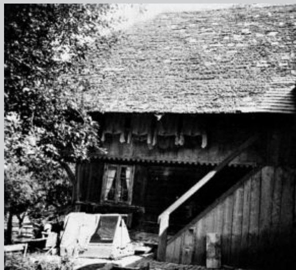
Fig. 42: maison à Henzenried FR endommagée par la grêle sur le toit de bardeaux. (Photos: archives UIR)
