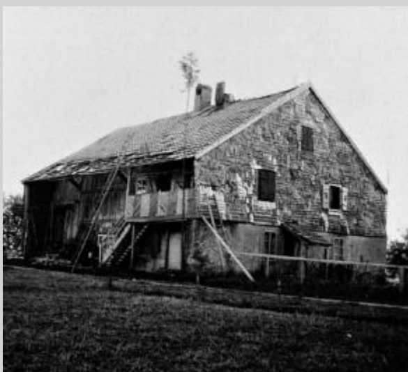
Fig. 41: maison à Fiaugères FR endommagée par la grêle sur la façade en bardeaux et par la tempête sur le toit.
