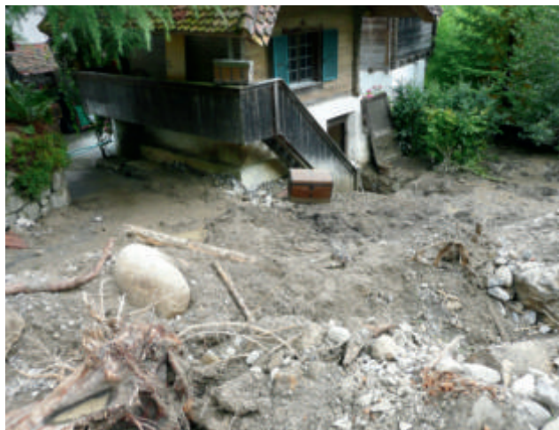
Abb. 10. Übersarungs-/Überflutungsschäden im Kegeltalbereich des Ralliggrabens oberhalb von Schloss Ralligen (Foto: Kellerhals + Haefeli AG).
