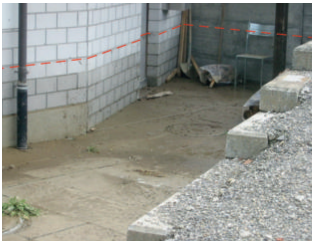
Abb. 9. Hochwasserspuren (strichlierte Linie) an einem Industriegebäude im Loulemoos bei Neuenegg; maximaler Wasserstand ca. 1 m (Foto: geo7 AG).
