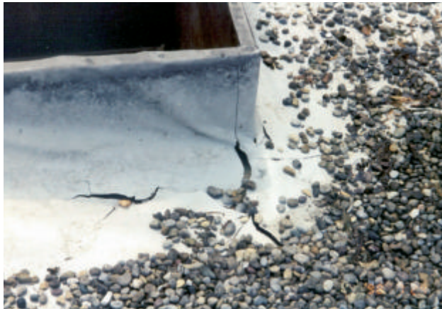
Abbildung 6.13: gealterte Dichtungsbahn, Foto GVL.
