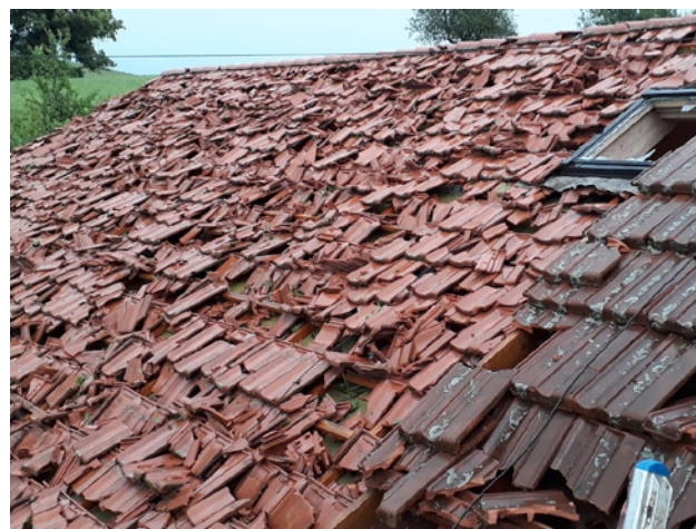
Abb. 12: Durch Hagelschlag schwer beschädigtes Ziegeldach in Wolhusen LU (Foto: GVL).
