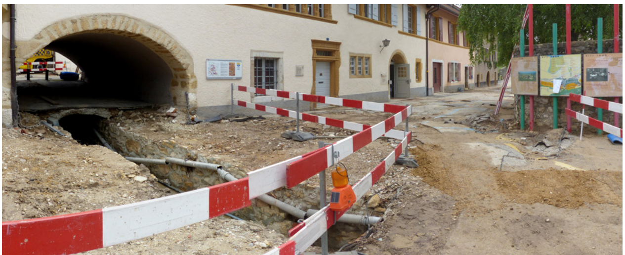
Abb. 9: Spuren des Unwetters im Dorfkern von Cressier (Rue Vallier) am 1. Juli 2021, also gut eine gute Woche nach dem Unwetter. Links die geöffnete Eindolungsstrecke des Ruhaut (Fotokomposit: IRV).
