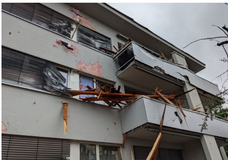
Abb. 15: Wohngebäude in Zürich-Altstetten mit zerrissenen Raffstoren, eingeschlagenen Fenstern und schweren Fassadenschäden infolge herumgewirbelten Holzes von abgerissenen Dachteilen eines Nachbargebäudes (Foto: GVZ).
