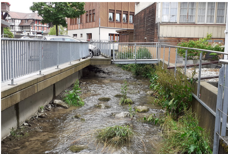
Abb. 29a, b: Die Massnahme funktioniert! Führt der Schwarzenburger Dorfbach wie am 13. Juli 2021 einen Abfluss von über 9 \text{ m}^3/\text{s} , leitet das 2009 erstellte Drossel- bauwerk (Bild 29a) das über- schüssige Wasser zwischenzeit- lich in ein Rückhaltebecken (im Hintergrund), das sich wieder entleert, sobald der Abfluss unter 9 \text{ m}^3/\text{s} sinkt. So wird das ent- sprechend dimensionierte Gerinne im talwärts gelegenen Ortskern von Schwarzenburg BE nicht über- lastet (Bild 29b; Fotos: IRV).
