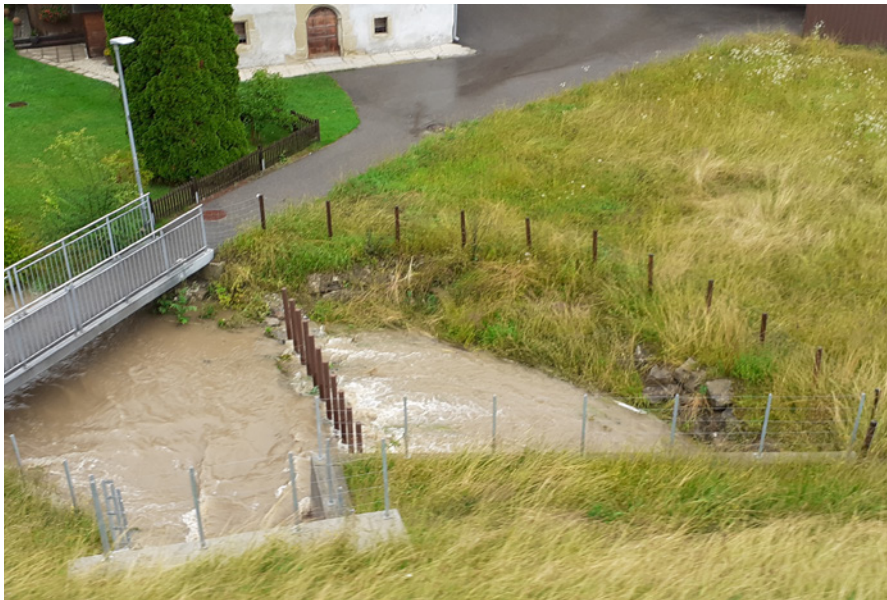
Abb. 30a, b: Die Massnahme funktioniert! Bei Hochwasser des Schwarzen- burger Dorfbachs wie am 13. Juli 2021 (Bild 30b) wird der zusätz- liche, mit einem Schwemmholz- rechen versehene Doppelrohr- Durchlass unter dem Bahndamm (Bild 30a links) aktiviert und so Verklausung und Rückstau verhindert. Vor der Erweiterung des Bauwerks 2013 wurden die in Bild 30b hinten links knapp erkennbaren Gebäude wiederholt überschwemmt (Fotos: IRV).
