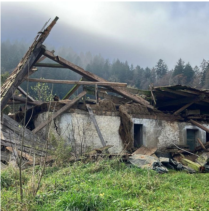
Abb. 43: Eingestürzter Dachstuhl eines landwirtschaftlichen Nutzgebäudes. Das Erscheinungsbild des Gebäudes erweckt den Eindruck, dass hier auch mangelhafter Unterhalt zum Schaden beigetragen hat. (Quelle: ECAP NE)
