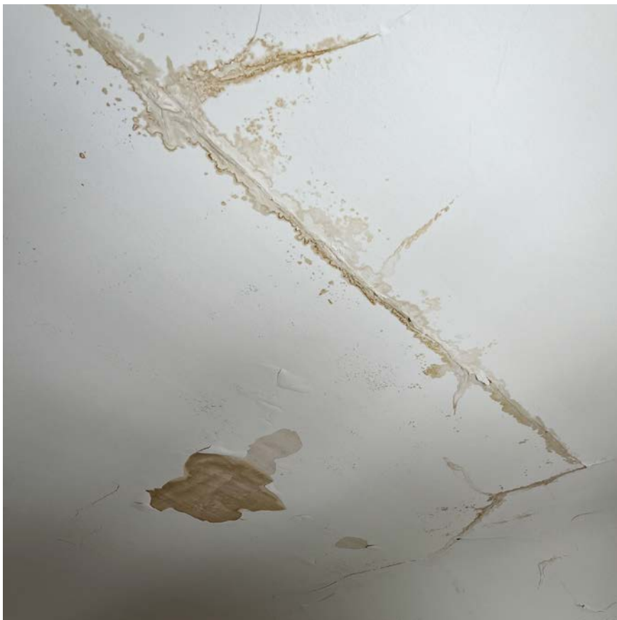
Abb. 35: Eindringenes Wasser hat den Anstrich der Decke beschädigt und die Bausubstanz durchnässt. In diesem Fall gelangte das Wasser durch das beschädigte Dach ins Gebäudeinnere. (Quelle: ECAP NE)
