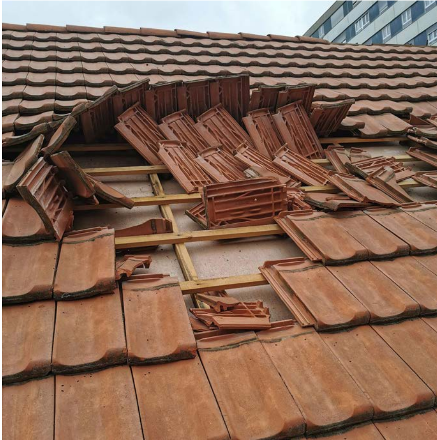
Abb. 26: Wie mit dem Fischschupper behandelt: Der punktuell kräftige Sog einer Sturmböe hat eine ganze Ziegelgruppe im Innern einer leewärtigen (windabgewandten) Steildachfläche aufgestellt und zum Teil überkippt. (Norden ist oben; Quelle: ECAP NE)
