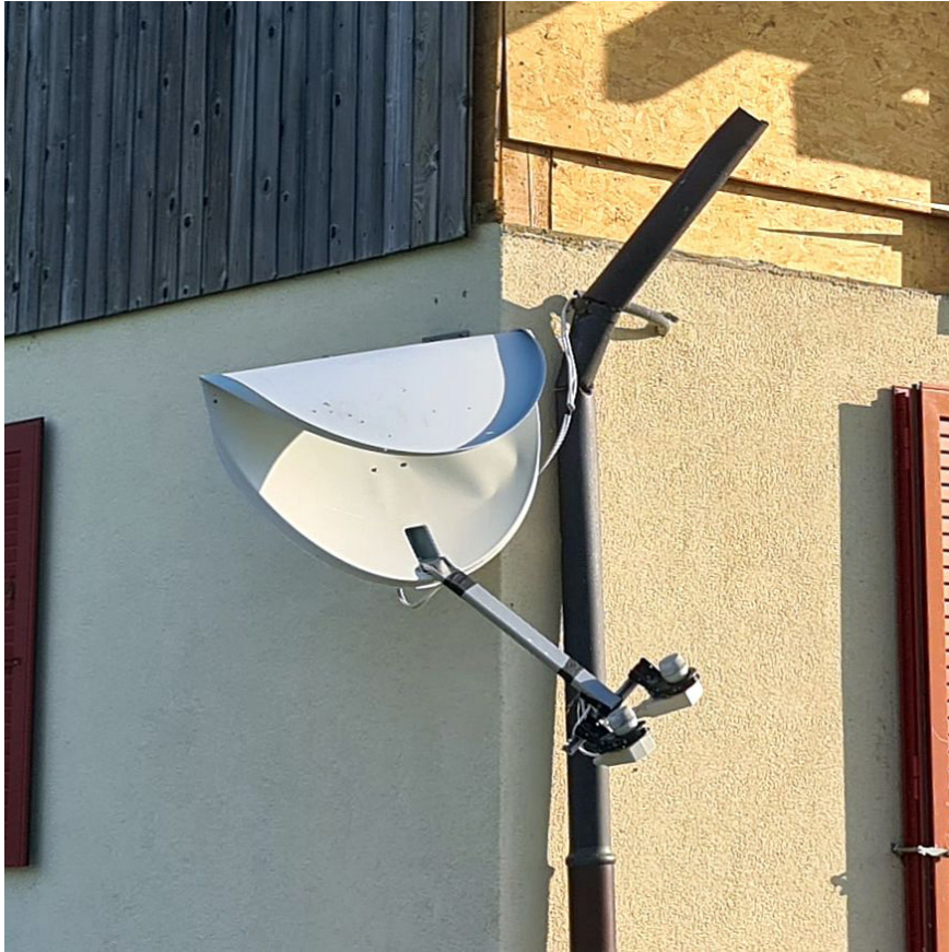
Abb. 56: Demolierte Parabolantenne an einem Wohngebäude. Diese wird zur Fahrhabe gerechnet und ist daher nicht im Deckungsumfang und somit auch nicht im Schadendossier der Gebäudeversicherung Neuenburg enthalten. (Quelle: ECAP NE)
