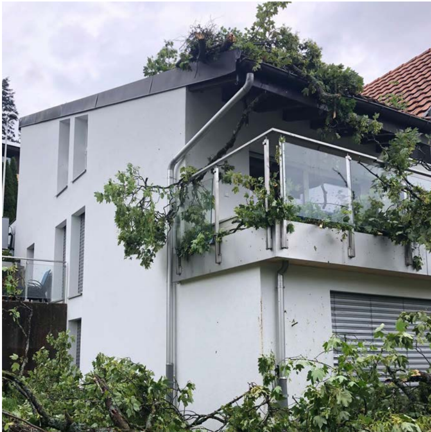
Abb. 34: Durch umgestürzten Bergahorn beschädigtes Gebäude. Die Schäden betreffen Dachrinne, Balkon und Fassade, also Bauelemente an Gebäudekanten. (Quelle: ECAP NE)
