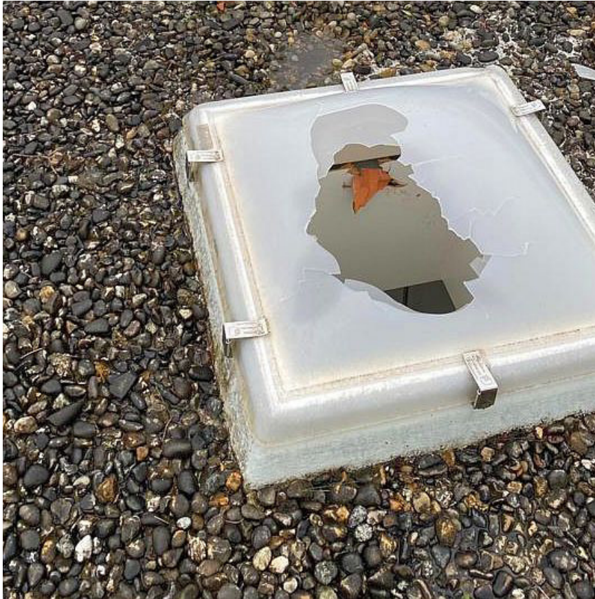
Abb. 36: Hier ermöglichte die doppelt durchschlagene Kunststoff-Lichtkuppel auf einem Flachdach dem Regenwasser den Zugang ins Gebäudeinnere. (Quelle: ECAP NE)
