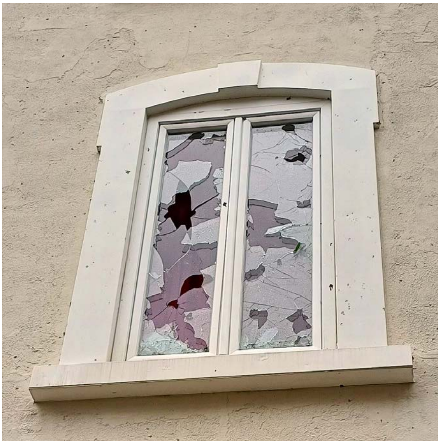
Abb. 44: Glasbruch wahrscheinlich infolge Trümmerschlags: Die punktförmigen Fassadenschäden und die mehrfachen Durchbruchstellen im Glas lassen auf Einschläge harter Körner als Ursache schliessen. Tatsächlich stehen direkt benachbart im Westen und Nordwesten zwei Gebäude mit kiesbedeckten Flachdächern. (Quelle: ECAP NE)
