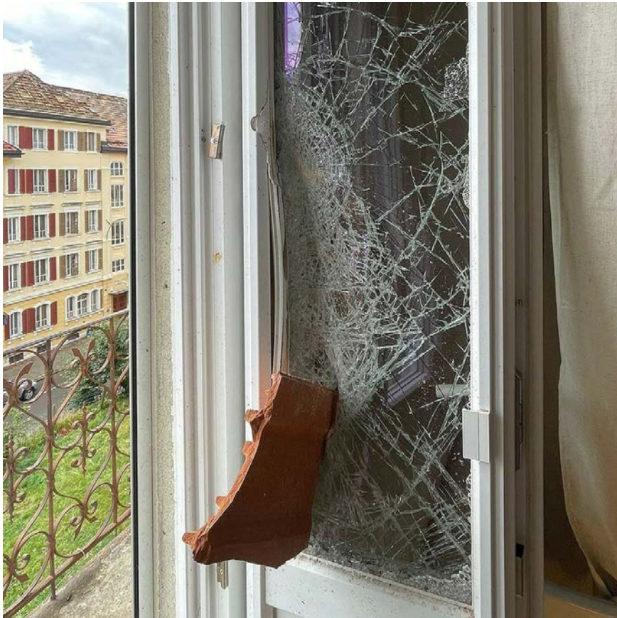
Abb. 45: Eindeutig Trümmerschlag: Der für den Schaden verantwortliche Dachziegel steckt noch in der Fensterscheibe. Der Spinnennetzbruch darüber weist rötliche Spuren auf, was nahelegt, dass die Scheibe mehrfach von Ziegeltrümmern getroffen wurde. (Quelle: ECAP NE)
