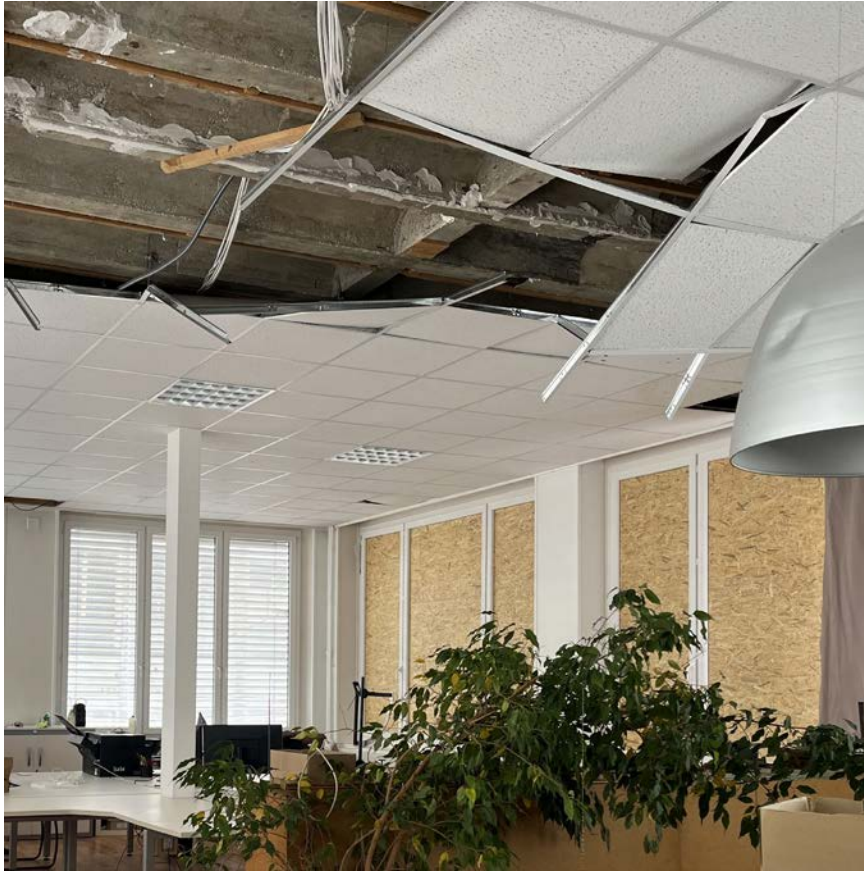
Abb. 29: Abgerissene Unterdecke: Die Gipskartonplatten hängen teilweise noch an ihren verbogenen Rahmenleisten. Die Spanplatten vor den Fenstern rechts im Raum erklären, was geschehen ist: Durch die zerstörten Fenster verschaffte sich der Sturm Zugang ins Gebäudeinnere. (Quelle: ECAP NE)
