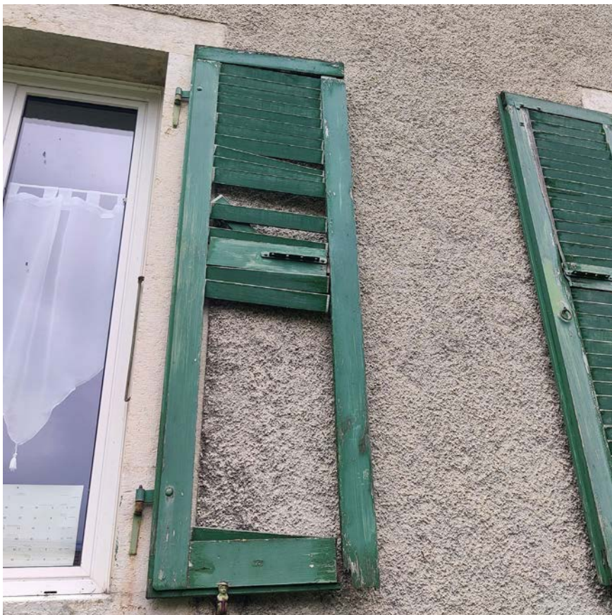
Abb. 52: Beschädigter älterer Fensterladen aus Holz: Etliche Lamellen sind aus dem Rahmen gefallen, nachdem sich dessen Eckverbindung unten rechts gelöst hatte. (Quelle: ECAP NE)
