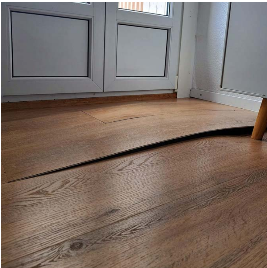
Abb. 37: Aufgebogenes Parkett infolge eingedrungenen Wassers – nicht ganz, was man sich spontan unter einem Sturmschaden vorstellt, aber dennoch eine häufige Erscheinung. (Quelle: ECAP NE)
