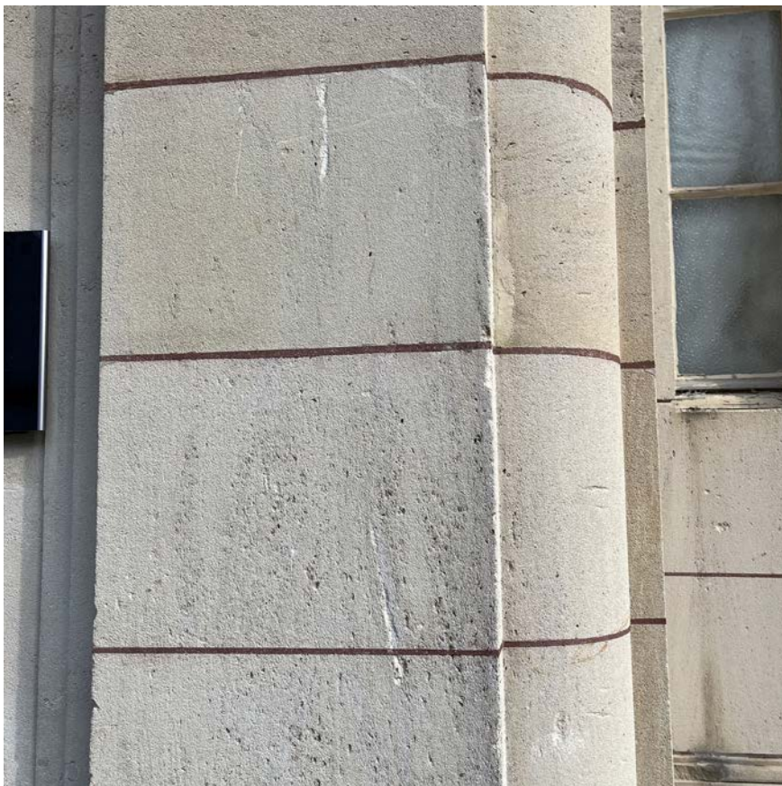
Abb. 46: Robust, aber doch nicht ganz unverwüsthlich: Naturstein-Fassade mit Beschädigungen durch Trümmerschlag an einer Villa mit Baujahr 1919. (Quelle: ECAP NE)
