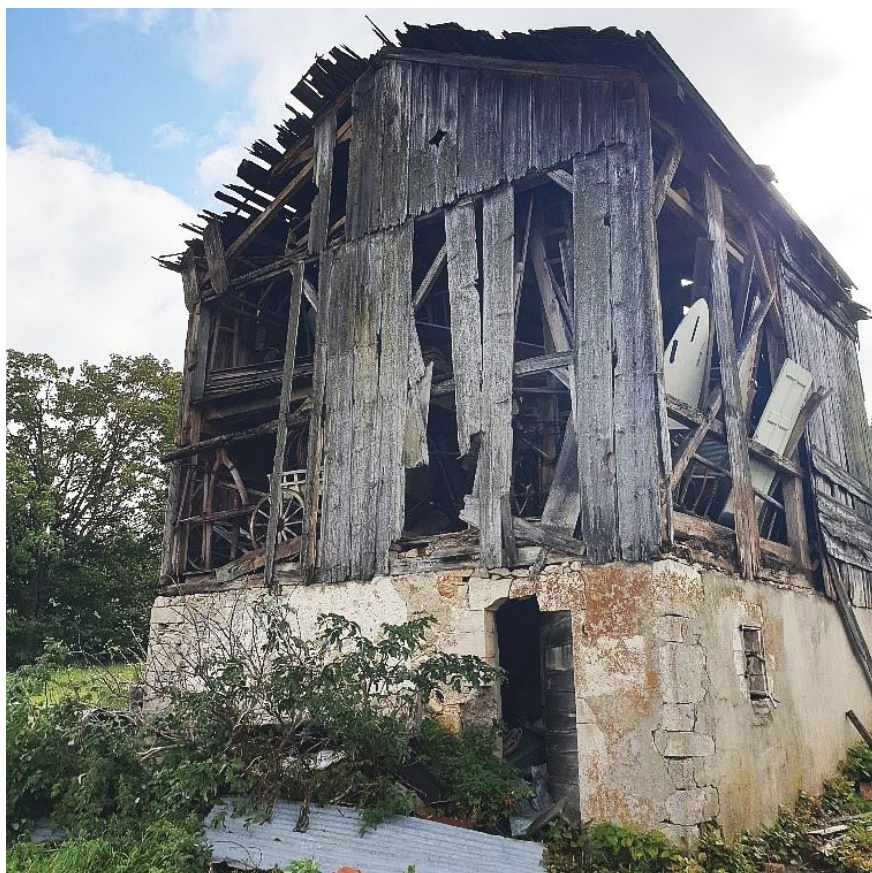
Abb. 22: Angesichts des Unterhaltszustandes dieses Schuppens erstaunt nicht, dass ihm der Sturm stark zugesetzt hat. (Quelle: ECAP NE)
