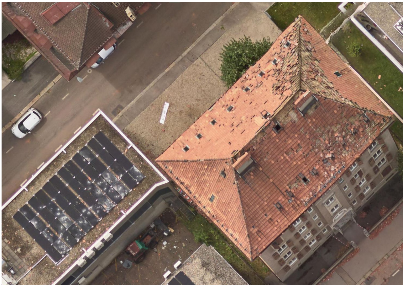
Abb. 23: Direkte Visualisierung von Trümmerschlag: Die Fotovoltaikanlage auf dem Flachdach des Gebäudes im Bild links wurde von abgeblasenen Dachziegeln des Nachbargebäudes rechts beschädigt (helle Flecken auf den Modulen). Einzelne Ziegel sind neben bzw. zwischen den Modulen erkennbar. Orthofoto vom 27. Juli 2023; aus perspektivischen Gründen ist hier ausnahmsweise Süden oben, und die Anströmung erfolgte von der oberen rechten Bildecke her. (Quelle: SITN)
