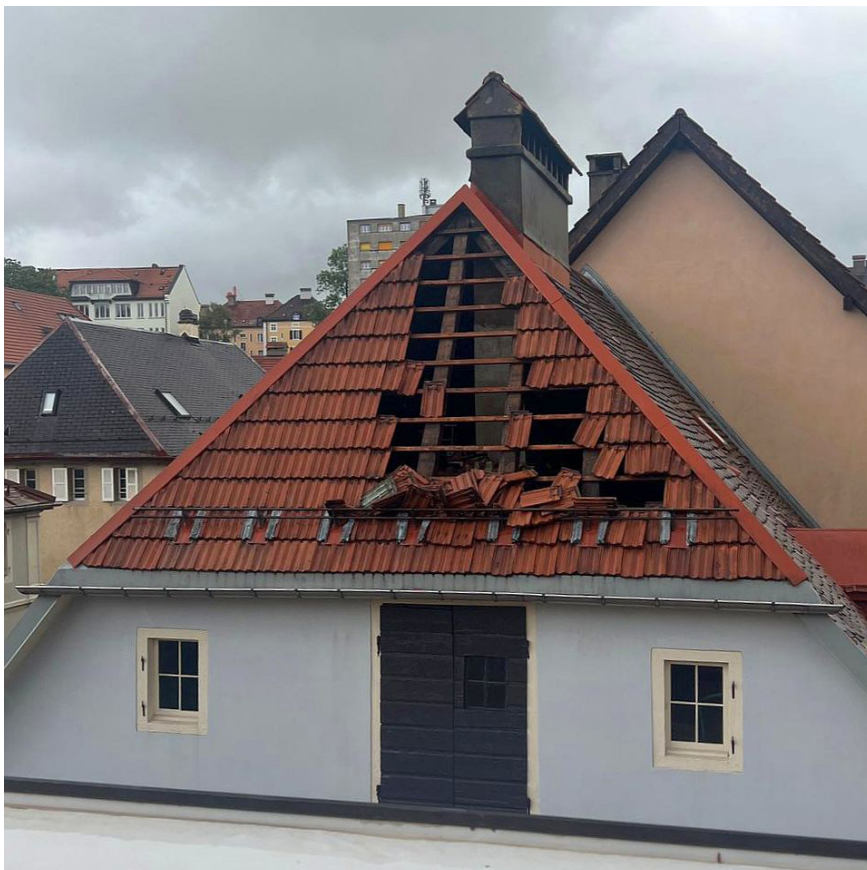
Abb. 39: Wohngebäude mit Baujahr 1902 und Steildach ohne Unterdach. Die aufgelegten Ziegel konnten dem Sturm nur wenig Widerstand leisten. Der Schneefang verhinderte den Absturz zumindest eines Teils der Ziegel. (Quelle: ECAP NE)
