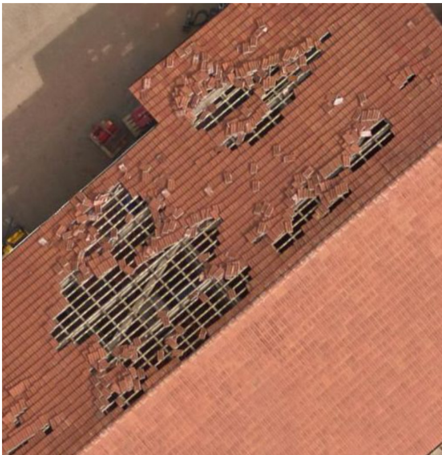
Abb. 27: Bei diesem Lagergebäude mit offenem Fahrzeugunterstand in La Chaux-de-Fonds fehlt ein Unterdach. Demzufolge wurde die Ziegeleindeckung grossflächig abgehoben. Orthofoto vom 27. Juli 2023. (Norden ist oben; Quelle: SITN)
