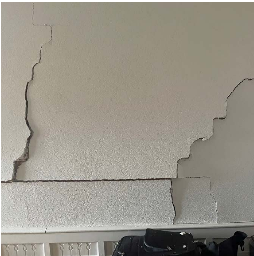
Abb. 30: Stark beschädigte Zwischenwand in einem älteren Wohngebäude. (Quelle: ECAP NE)
