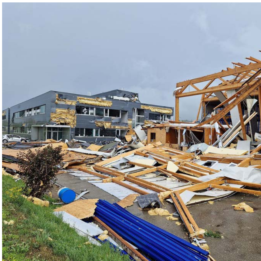
Illustration 15 : Point focal des dommages, au Crêt-du-Locle. Les grands bâtiments industriels en construction légère n'ont pas été en mesure de résister à la tempête, et ils ont subi d'importants et coûteux dommages au niveau de leurs enveloppes, voire même au niveau des structures porteuses. (source : ECAP)
