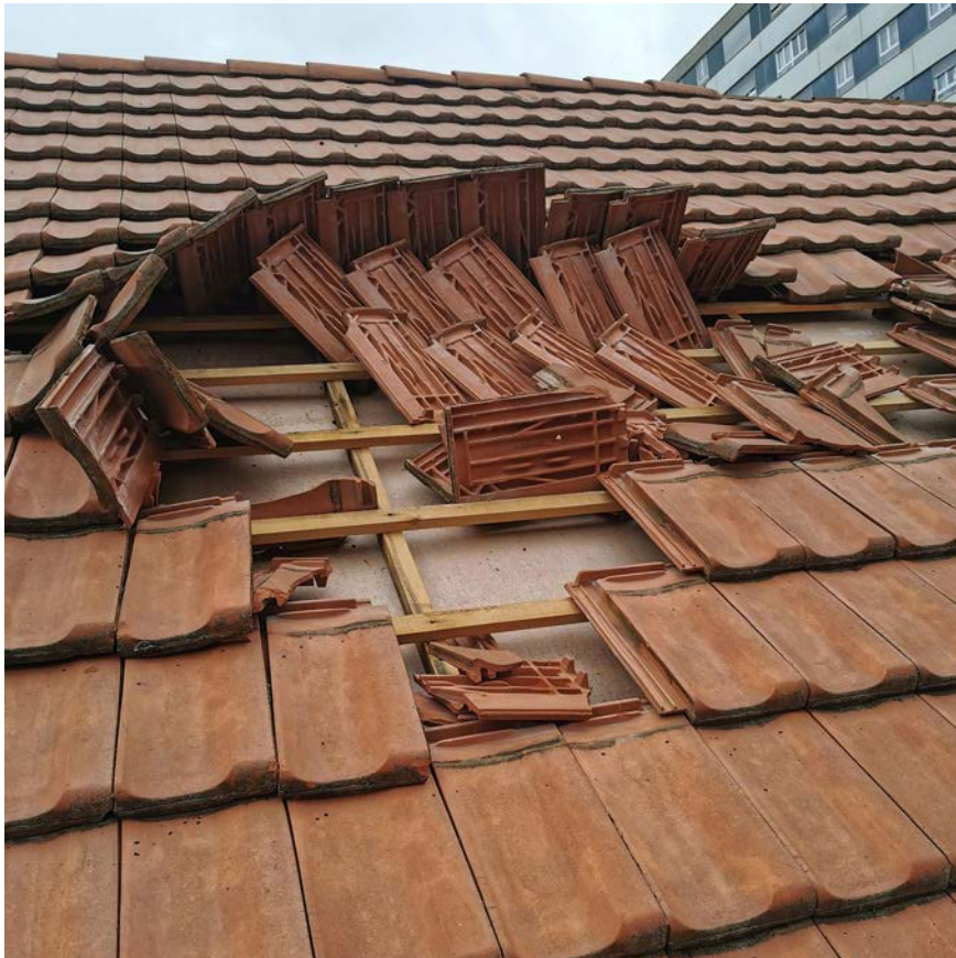
Illustration 26 : Comme si on avait passé un écailleur : sur la surface d'un toit incliné située sous le vent (c. à d. pas exposée directement au vent), la puissante force de succion ponctuelle d'une rafale a soulevé tout un groupe de tuiles se trouvant au milieu de la surface et les a dressées, voire complètement retournées. (source : ECAP)
