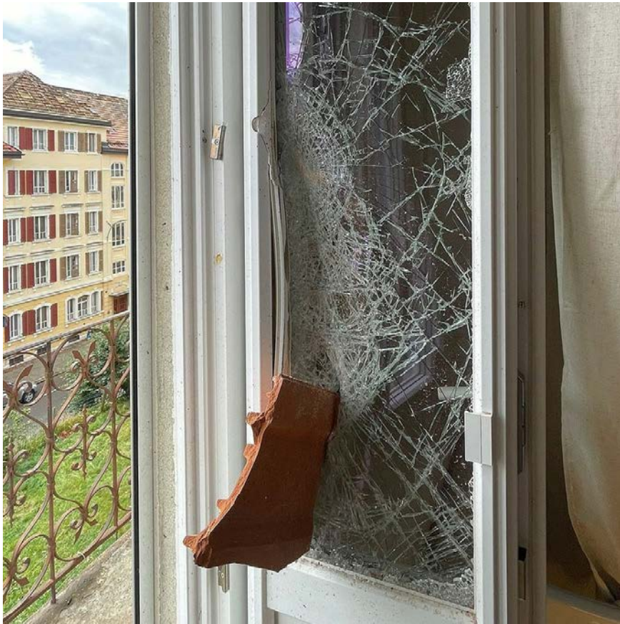
Illustration 45 : De toute évidence des impacts de débris emportés : une tuile transportée par le vent est encore plantée dans la vitre. Au-dessus, on reconnaît des traces rougeâtres sur les centres des fissures en forme de toile d'araignée, suggérant que la fenêtre a été heurtée à plusieurs reprises par des débris de tuiles. (source : ECAP)
