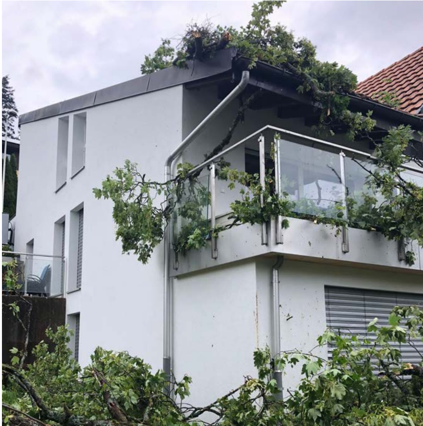
Illustration 34 : Bâtiment endommagé par la chute d'un érable de montagne. Les dommages concernent la gouttière, le balcon et la façade, c'est-à-dire des éléments de construction qui forment des angles. (source : ECAP)
