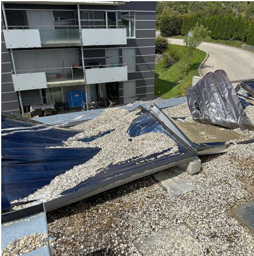
Illustration 41 : Gravier sur un toit plat moderne (année de construction 2006). La tempête a soulevé les gravillons et les a en partie projeté au-delà du bord du toit. (source : ECAP)
