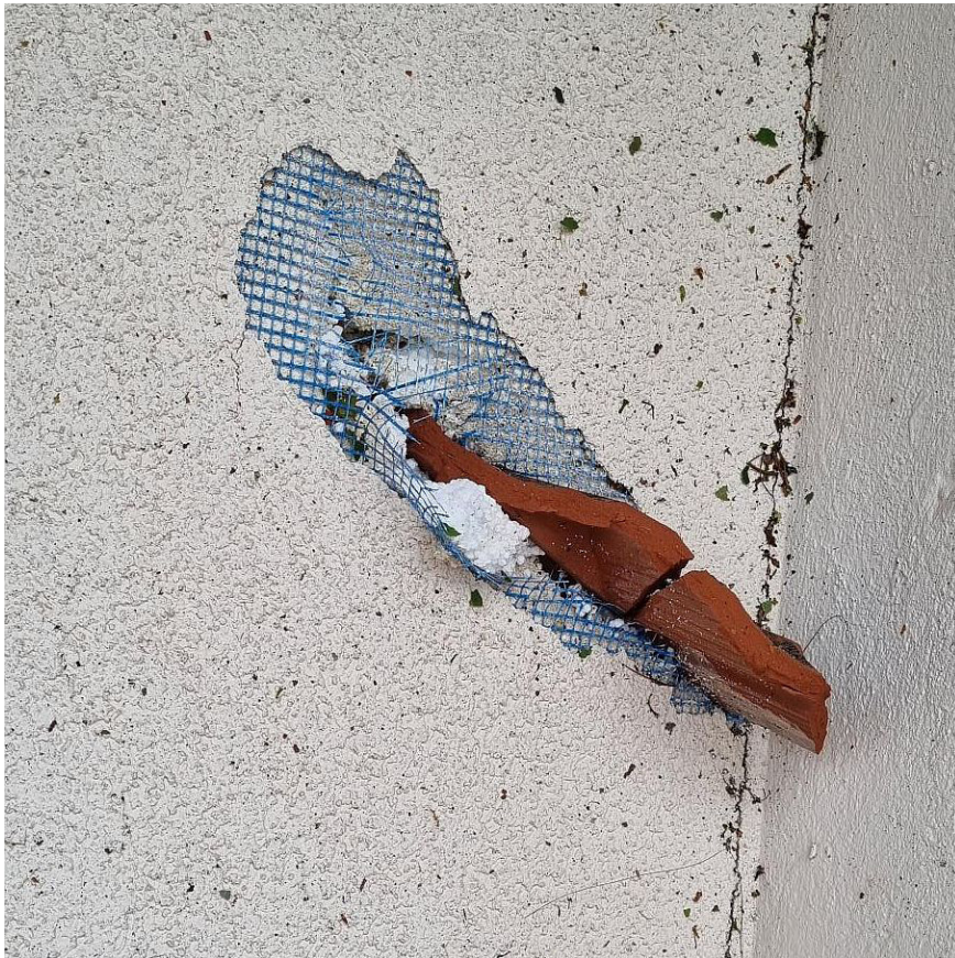
Illustration 48 : Un éclat de tuile est resté planté dans la couche d'isolation extérieure posée sur un bâtiment d'habitation construit en 1965, dont la performance énergétique a été améliorée dans le cadre de travaux de rénovation. Le crépi écaillé laisse bien apparaître le treillis de renforcement bleu, ainsi que le matériau d'isolation (polystyrène) qui a été partiellement poussé vers l'extérieur. Aucun des matériaux utilisés n'a été en mesure de résister à l'impact du fragment de tuile. (source : ECAP)
