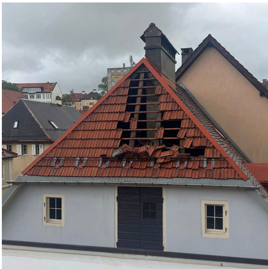
Illustration 39 : Bâtiment d'habitation construit en 1902, avec un toit en pente dépourvu d'une sous-couverture. Les tuiles n'ont offert que peu de résistance à la tempête. Le pare-neige a néanmoins empêché la chute de nombreuses tuiles. (source : ECAP)
