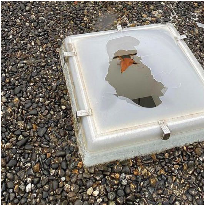
Illustration 36 : Les deux coques en matière synthétique de cette coupole d'éclairage placée sur un toit plat ont été perforées, permettant à l'eau de pluie d'entrer dans le bâtiment. (source : ECAP)
