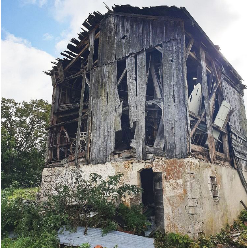
Illustration 22 : Au vu de son mauvais état d'entretien, il n'est pas surprenant que cette remise ait subi d'importants dommages au passage de la tempête. (source : ECAP)
