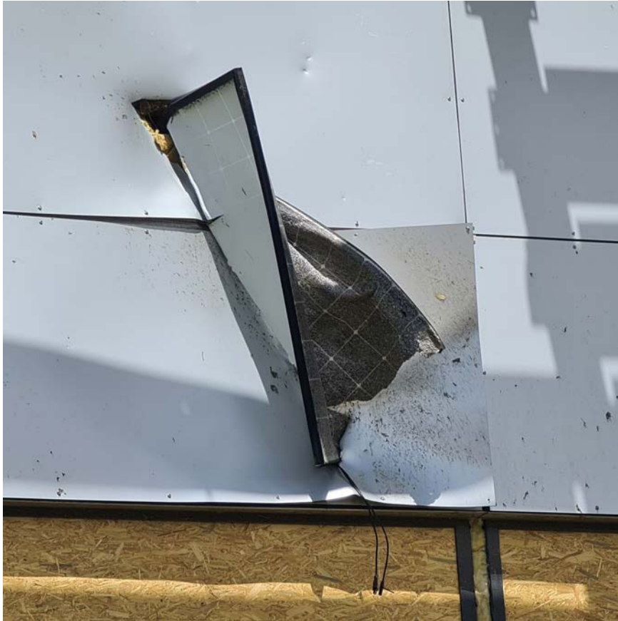
Illustration 53 : Une preuve de la violence de la tempête : un module photovoltaïque arraché s'est transformé en un dangereux projectile. Il a transpercé le revêtement en tôle d'un bâtiment voisin et y est resté planté. Il s'agit probablement d'une installation solaire de balcon qui était fixée de manière insuffisante. (source : ECAP)
