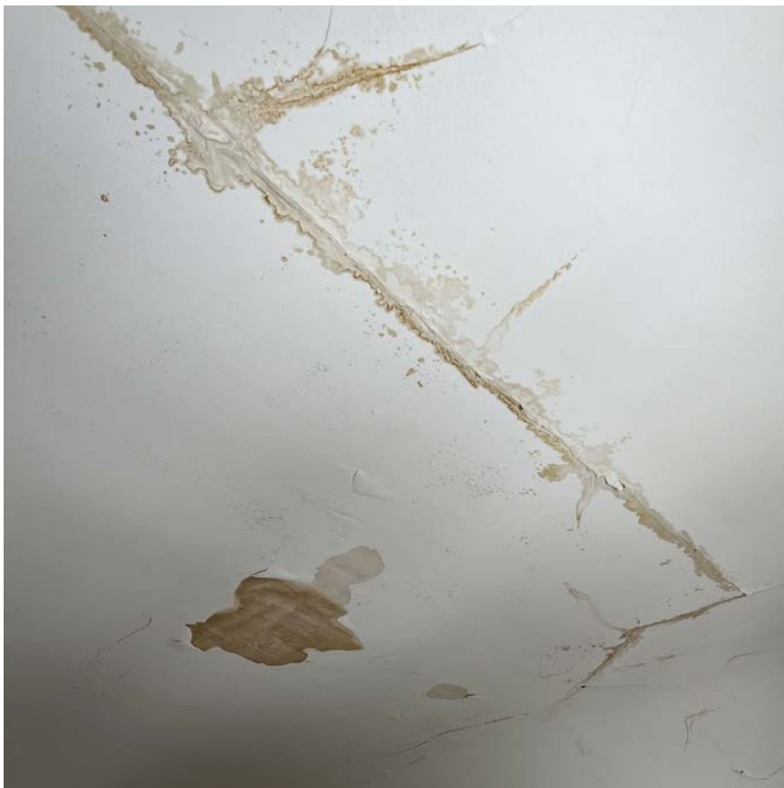
Illustration 35 : De l'eau qui a pénétré dans le bâtiment a imbibé la dalle formant le plafond et a endommagé la peinture. Dans ce cas précis, l'eau est entrée par des brèches dans la toiture. (source : ECAP)
