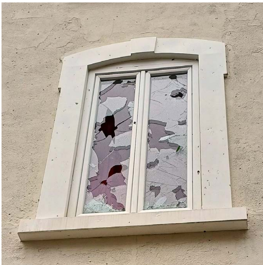
Illustration 44 : Bris de verre, probablement dû à des impacts de débris emportés : les dommages sous forme de points sur la façade ainsi que le fait que les vitres ont été transpercées en plusieurs endroits invitent à penser que les impacts sont dus à des grains durs. Et en effet, dans le voisinage immédiat, à l'ouest et au nord-ouest, il y a deux bâtiments dont les toits plats sont recouverts de gravier. (source : ECAP)
