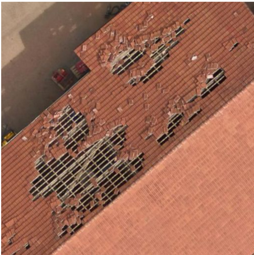
Illustration 27 : Sur ce bâtiment de stockage situé à La Chaux-de-Fonds, qui comprend un abri pour véhicules ouvert sur le côté, le toit a été construit sans sous-couverture, ce qui a permis au vent de soulever les tuiles sur une grande surface. Orthophoto du 27 juillet 2023. (le nord se trouve en haut de l'image ; source : SITN)
