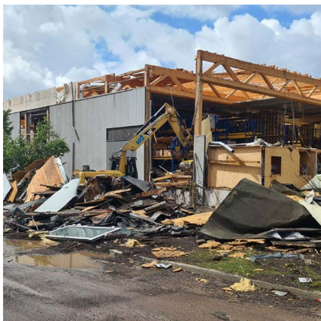
Illustration 65 : Bâtiment industriel gravement endommagé au Crêt-du-Loclc ; les dommages concernent la couverture du toit ainsi que des éléments de façade et des parois. (source : ECAP)
