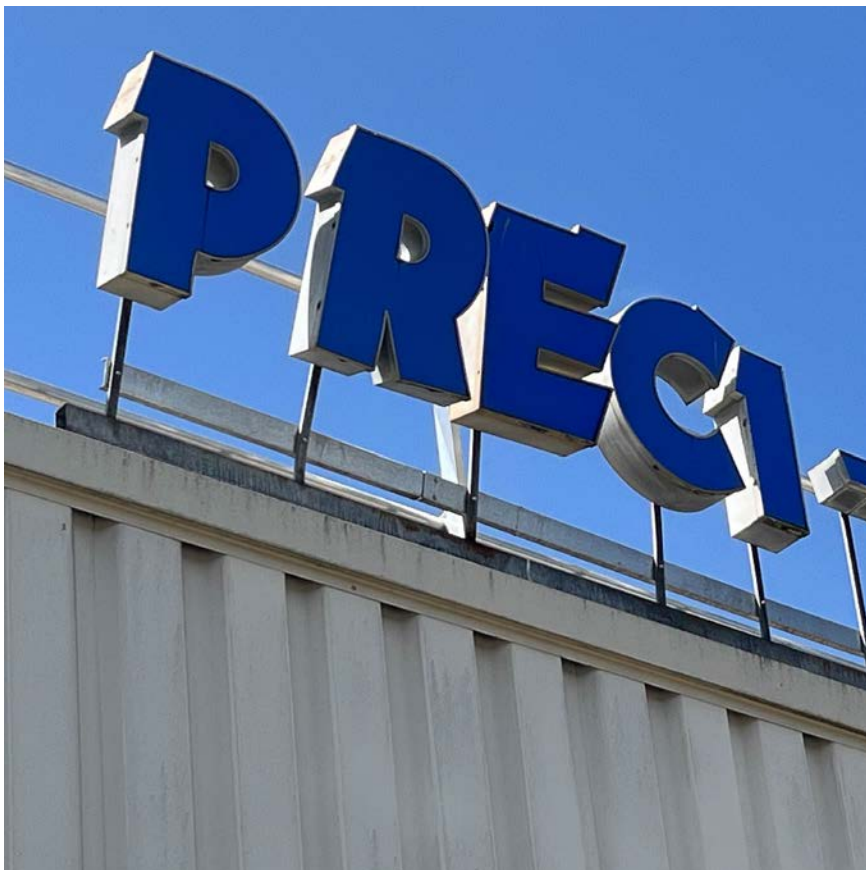
Illustration 31 : Sur un bâtiment industriel moderne, la pression du vent a plié certaines tiges servant de support aux lettres formant l'enseigne de l'entreprise. (source : ECAP)
