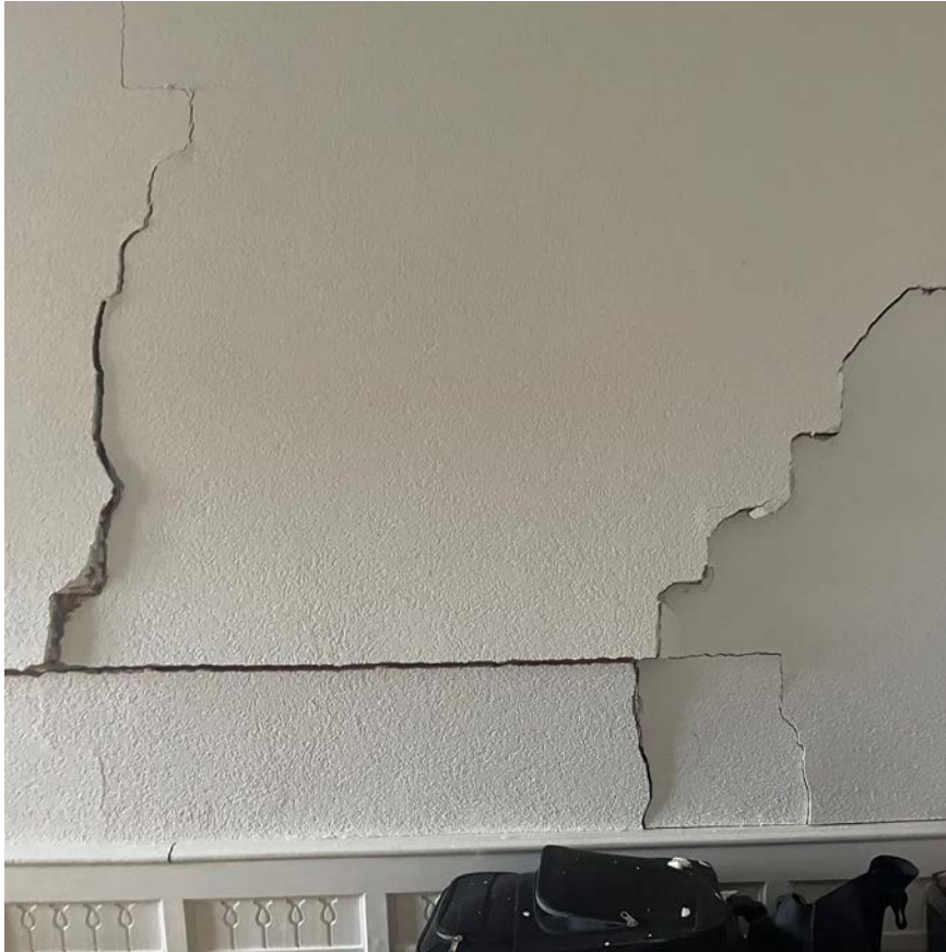
Illustration 30 : Paroi fortement endommagée dans un bâtiment d'habitation d'un certain âge. (source : ECAP)
