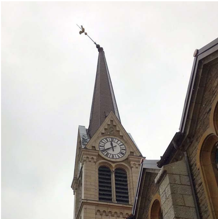
Illustration 18 : La pointe posée sur la flèche du Temple de l'Abeille et servant de support au coq doré a été tordue par la tempête. La photo a été prise le jour même de l'événement, juste après le passage de la tempête, comme le prouve l'heure affichée par l'horloge. (source : ECAP)
