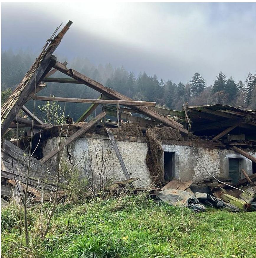
Illustration 43 : Sur un bâtiment d'exploitation agricole, la charpente de toit s'est effondrée. L'apparence générale du bâtiment suggère que le dommage pourrait avoir été favorisé par un entretien insuffisant. (source : ECAP)
