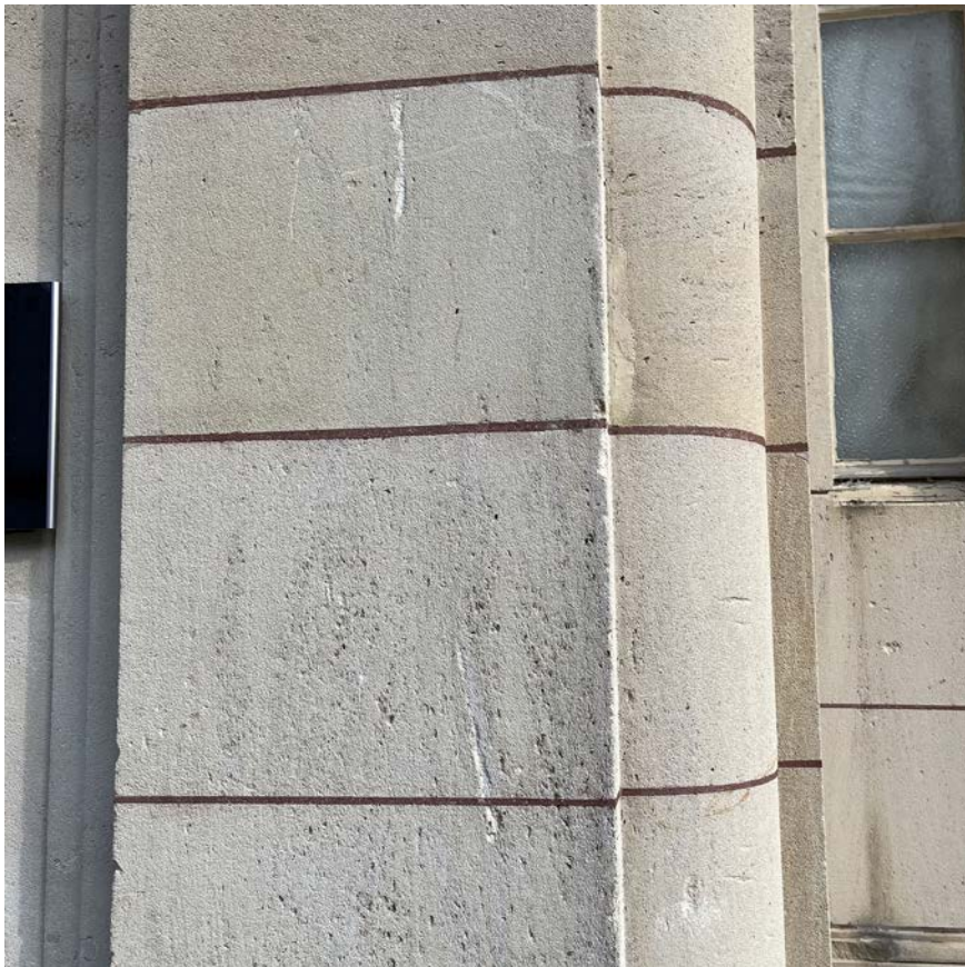
Illustration 46 : Robuste, mais pas tout à fait indestructible : sur cette villa construite en 1919, la façade en pierre naturelle présente des dommages causés par impacts de débris emportés. (source : ECAP)
