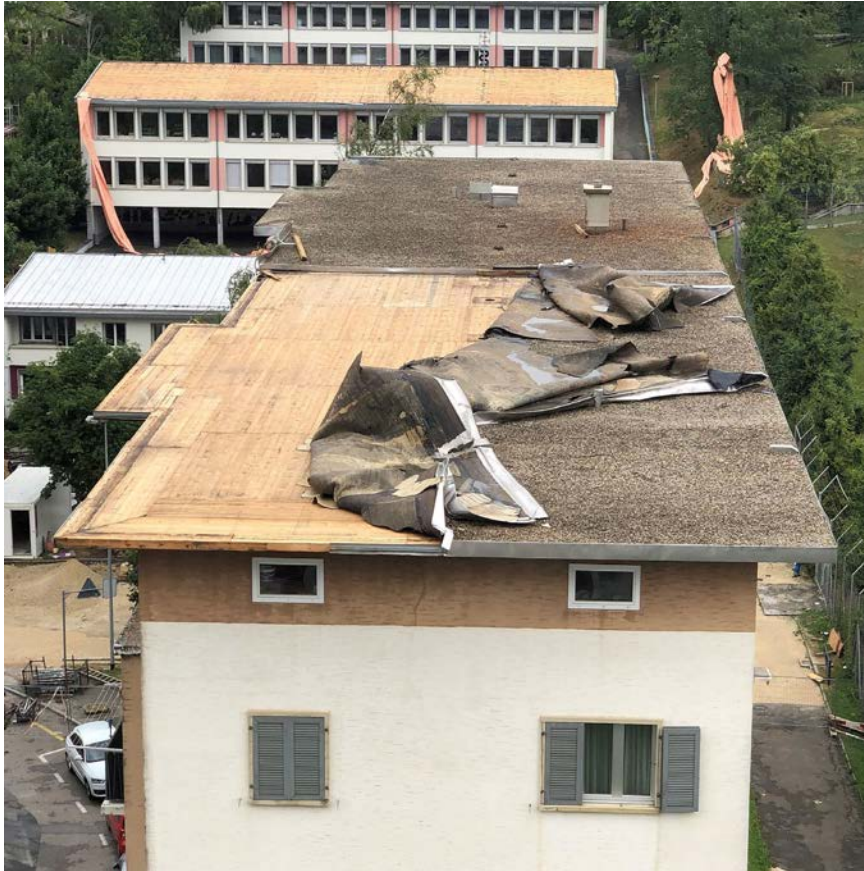
Illustration 40 : Lés d'étanchéité arrachés sur le toit plat d'un bâtiment d'habitation construit en 1954. Probablement, le revêtement de bordure, en tôle, a cédé en premier, laissant ainsi le vent avoir prise en se glissant sous les lés. En arrière-plan, on aperçoit un bâtiment construit de manière similaire, sur lequel toute la couverture du toit a été arrachée. (source : ECAP)
