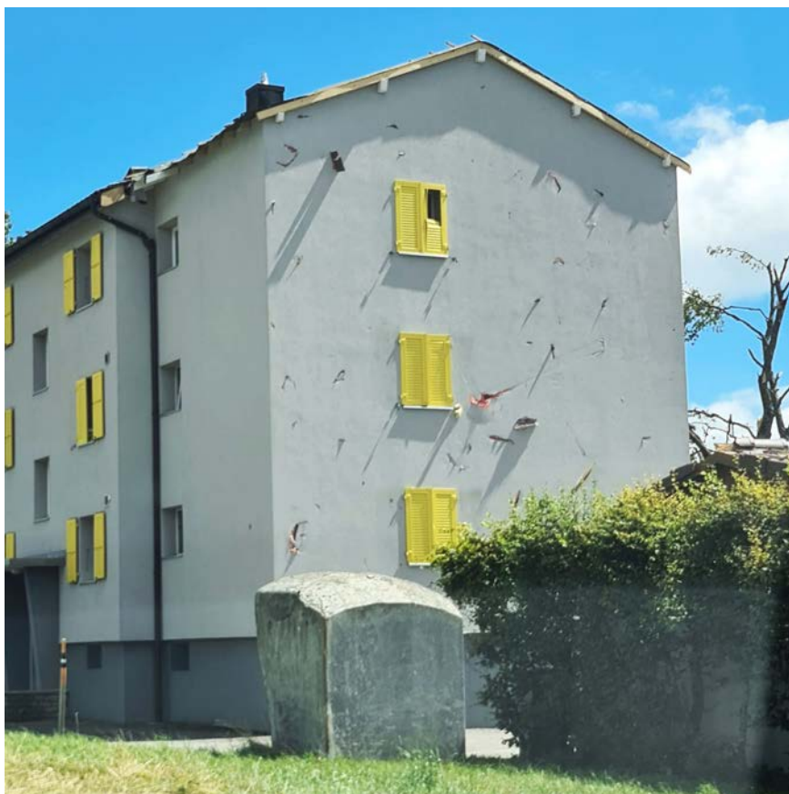
Illustration 47 : Bâtiment d'habitation construit en 1965, dont la performance énergétique a été améliorée, dans le cadre de travaux de rénovation, au moyen d'une isolation extérieure enduite de crépi. La façade a été lourdement endommagée par des débris emportés par les vents tourbillonnants, certains étant encore plantés dans la façade. En outre, la couverture du toit a été arrachée sur environ un tiers de sa surface. (source : ECAP)
