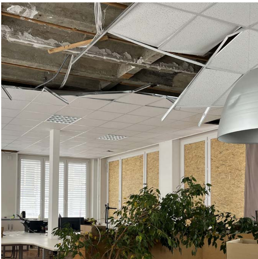
Illustration 29 : Un plafond suspendu arraché : certaines plaques en carton-plâtre sont encore accrochées aux profilés tordus de leurs cadres de fixation. Les panneaux d'aggloméré insérés dans les fenêtres que l'on voit sur la droite du local expliquent ce qui s'est passé : la tempête a brisé les fenêtres et a ainsi pu s'introduire dans le bâtiment. (source : ECAP)
