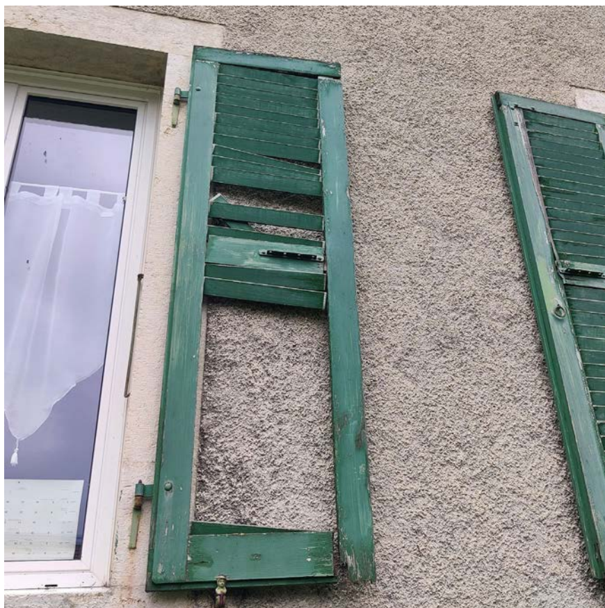
Illustration 52 : Dommages sur un volet en bois d'un certain âge : de nombreuses lamelles ont glissé hors du cadre après que l'assemblage formant l'angle inférieur droit s'est désolidarisé. (source : ECAP)
