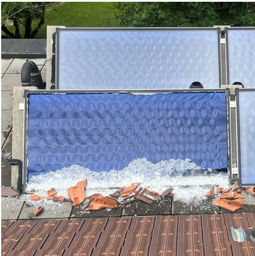
Illustration 54 : Module photovoltaïque détruit par des impacts de débris emportés. Les éclats de tuiles qui ont causé le dommage reposent au pied du module. (source : ECAP)
