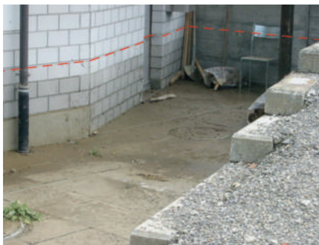
Figure 9: niveau visible de l'eau (ligne hachurée) dans un bâtiment industriel de Louelemoos, à Neuenegg. L'eau a atteint approximativement 1 m (photo: geo7 AG).
