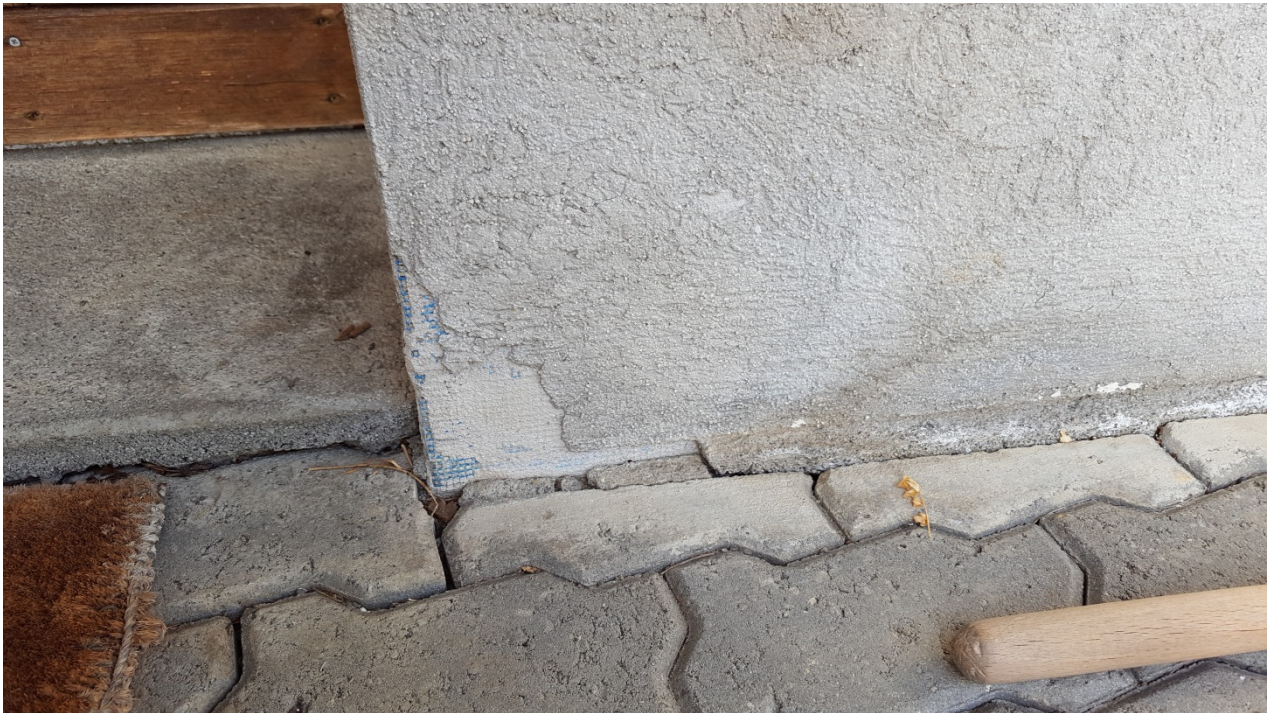
Bild 31: Abplatzung der Deckschicht durch mechanische Beschädigung (vermutlich durch Schläge von Schneeschuhen oder einer Schneeschaufel) kombiniert mit Frost-Tau-Zyklen, Beispiel an einem Gebäude in Grindelwald.
