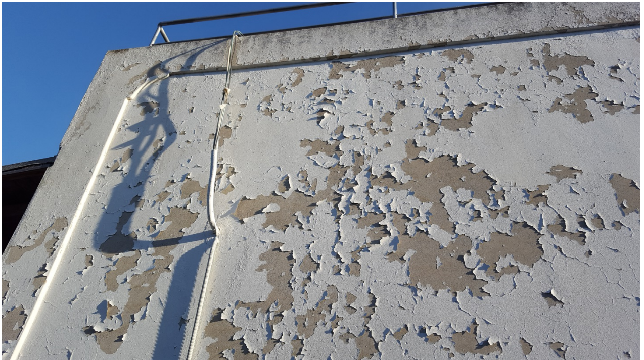
Bild 33: Massive Abplatzung der Deckschicht auf einem Verputz; vermutlich durch falsche Materialkombination (Acrylfarbe auf organischem Verputz?) bei aggressivem mediterranem Klima (Salzwasser und Wind), Beispiel an einem Gebäude in Stromboli (Insel in Süditalien).
