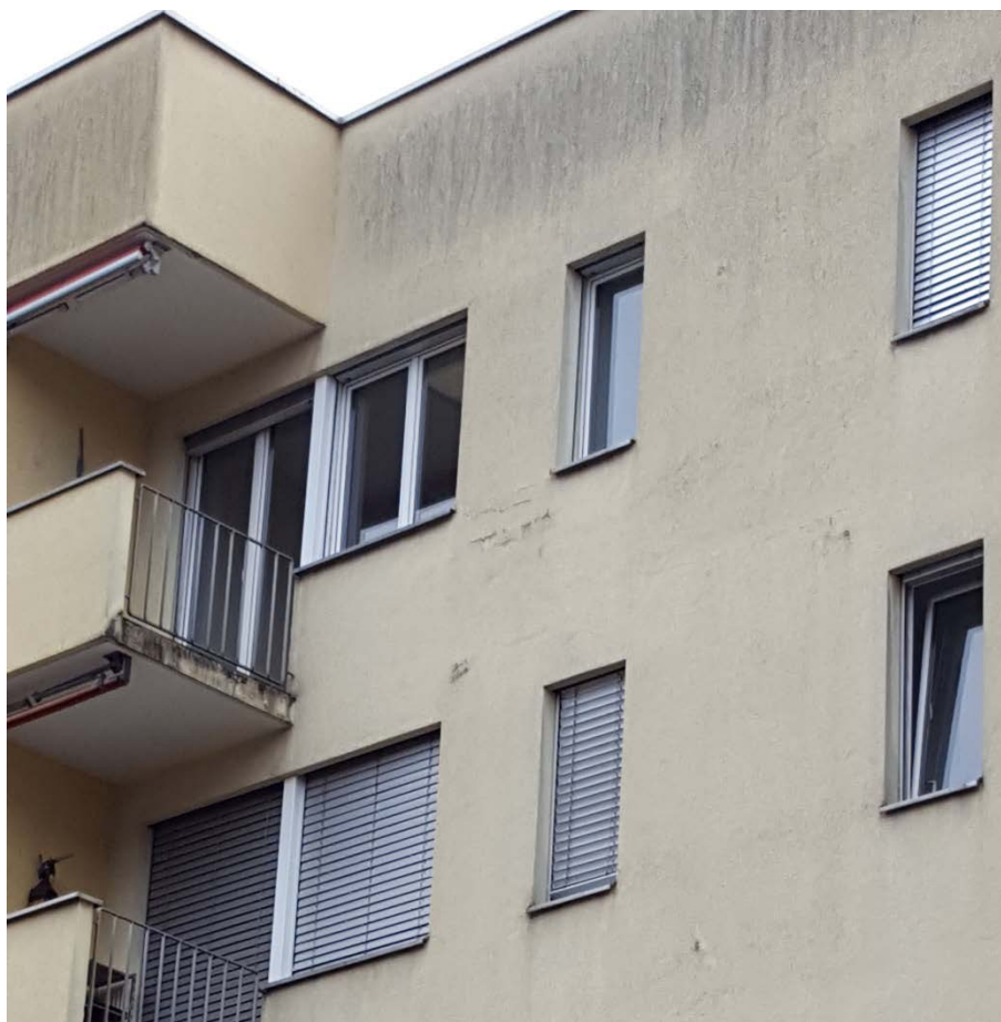
Bild 29: Verfärbung des Anstriches durch Algenbefall, Beispiel an einem Gebäude in Zürich.
