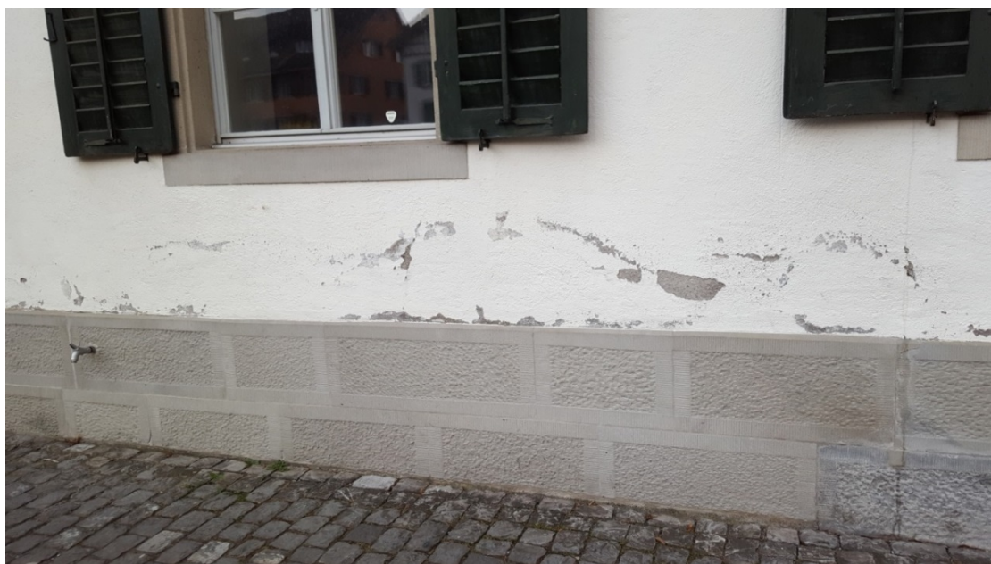
Bild 27: Rissbildung und Abplatzung der Deckschicht an einer verputzten Steinmauer durch zu hohe Feuchtigkeit und Frost-Tau-Zyklen, Beispiel an einem Gebäude in Küsnacht.
