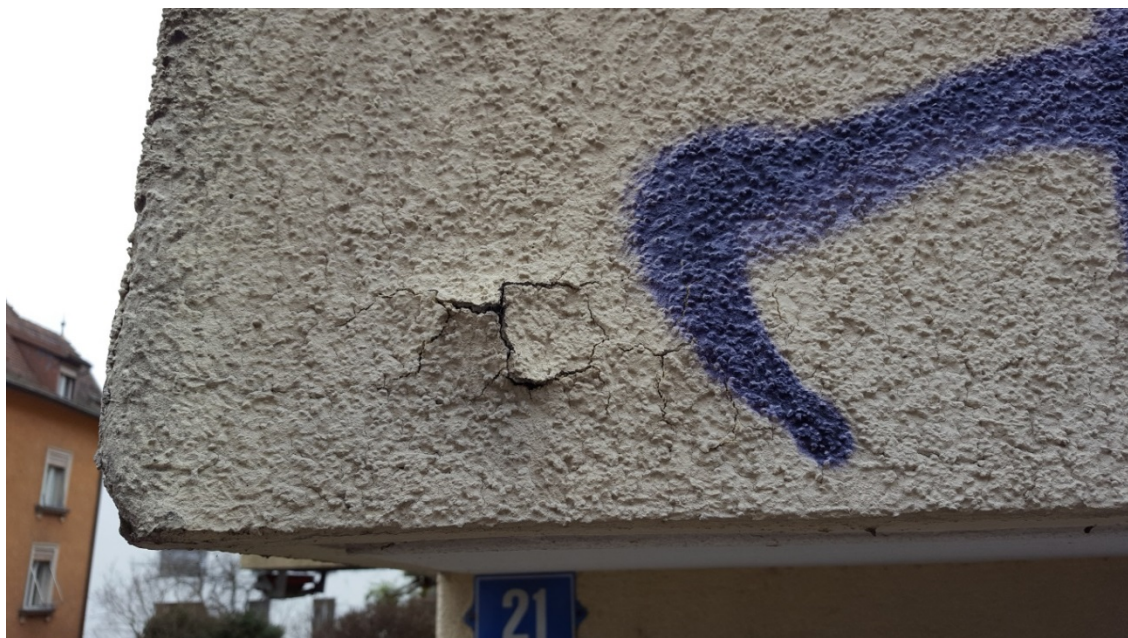
Bild 26: Blasen- und Rissbildung, Beispiel an einem Gebäude in Zürich.
