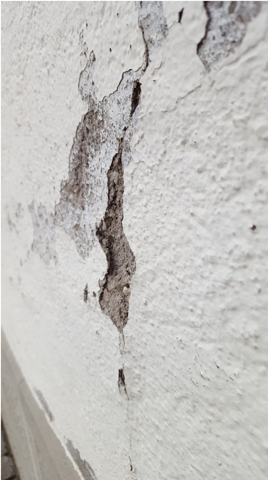
Bild 28: Detail von Bild 29: Ablättern des Farbanstriches und Abplatzung des Deckverputzes im Bereich eines ausgedehnten Risses.
