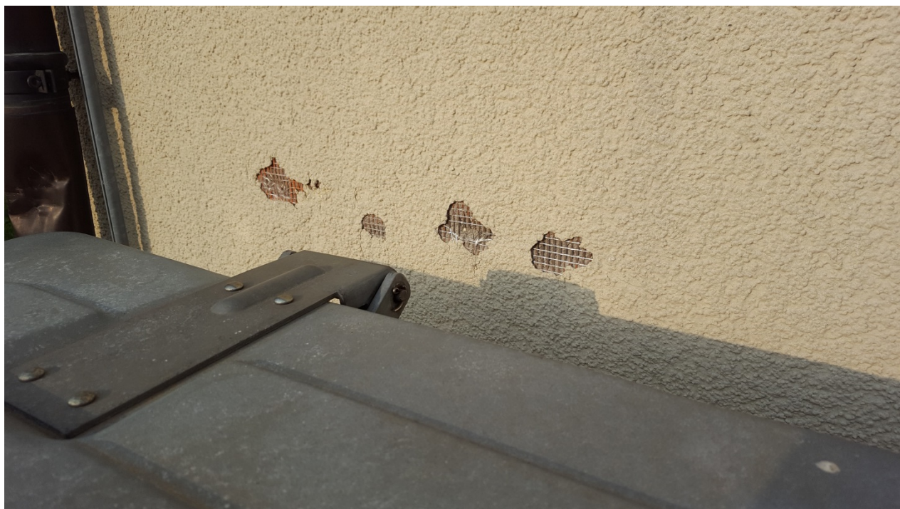
Bild 30: Abplatzung der Deckschichten an einer mit einem WDVS sanierten Fassade durch mechanische Beschädigung (Container-Stösse), Beispiel an einem Gebäude in Zürich.
