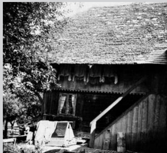
Abb. 42: Haus in Henzenried FR mit Hagelschäden am Schindeldach. (Fotos: Archiv IRV)
