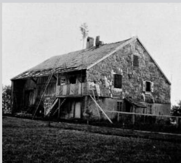
Abb. 41: Haus in Fiaugères FR mit Hagelschäden an der Schindelfassade und Sturmschäden am Dach.
