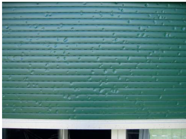
Abb. 19: Typischer Hagelschaden an einem Rollladen: die Hagelschlossen haben deutliche Dellen hinterlassen (Foto: AGV).
