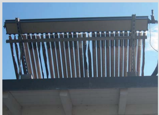
Abb. 28: Oben defektes Fotovoltaikelement, unten beschädigter Röhrenkollektor (Fotos: AGV).
