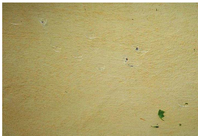
Abb. 20: Typischer Hagelschaden an einer Fassade: Risse und Abplatzungen im Verputz (Foto: AGV).
