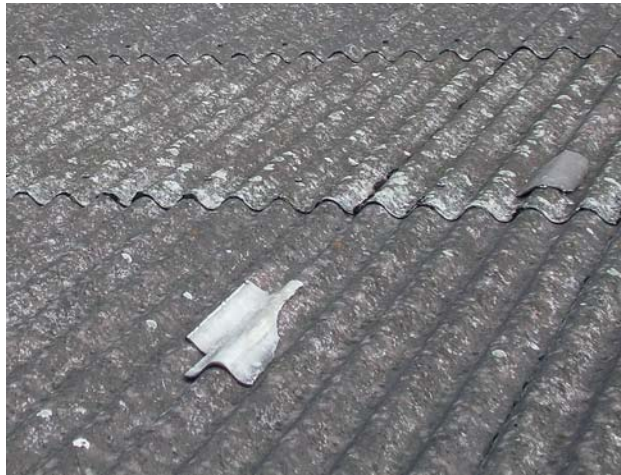
Abb. 21: Typischer Hagelschaden an einem Wellblechdach: die Hagelkörner haben Absplitterungen und – im Bild nicht erkennbar – Risse verursacht (Foto: AGV).
